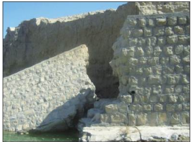
▲ تخریب بخشی از دیوار اجرا شده در اثر جاری شدن سیل
