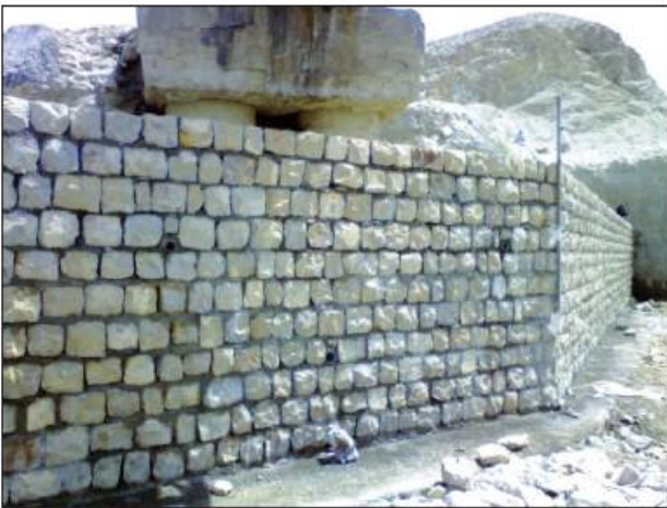
▲ دیوار سنگی اجرا شده قبل از خسارت
