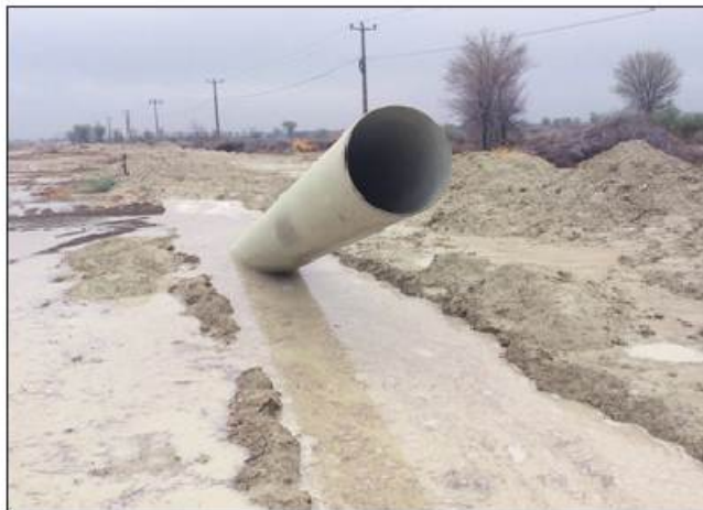
● در تصویر بالا برداشت ضایعاتی از جمله گل ولای و لجن در مجاورت لوله خسارت دیده به دلیل وقوع سیل، برای ادامه کار و ترمیم خسارت لازم و ضروری است.
